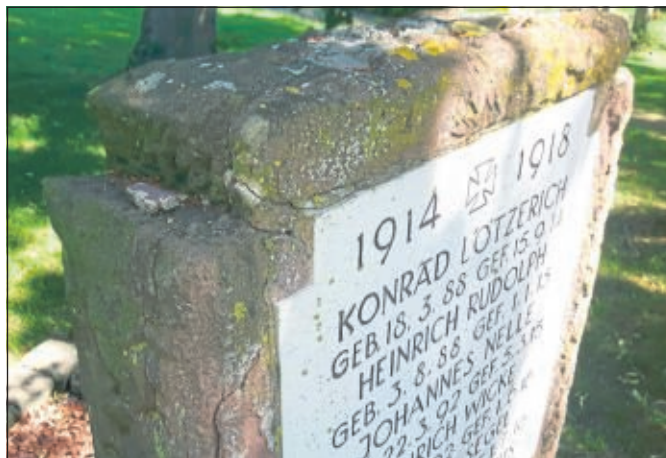
Schadensbild der vorherigen Kreuze.
