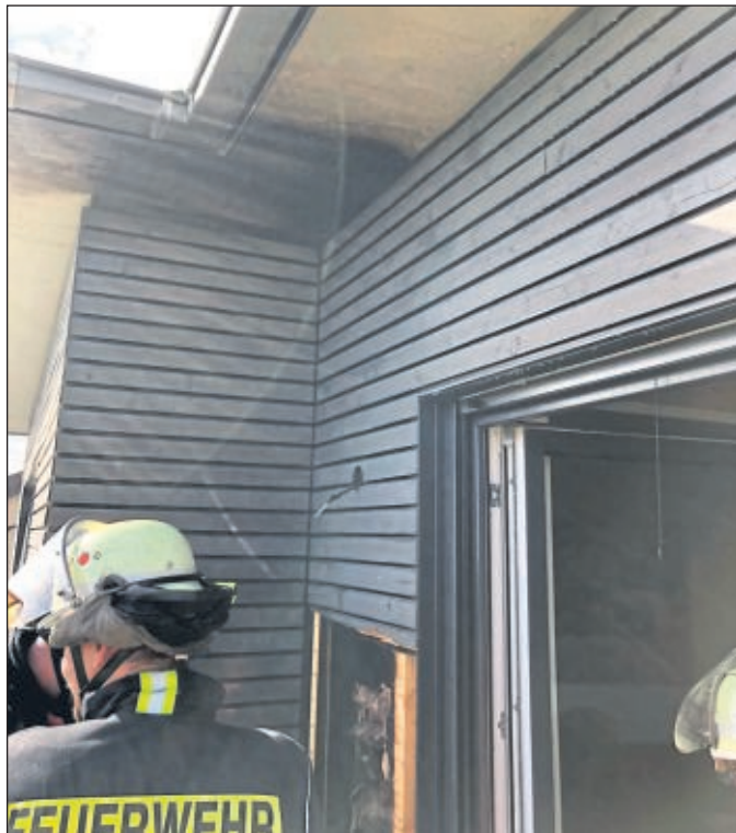
Brand im Aussenbereich
